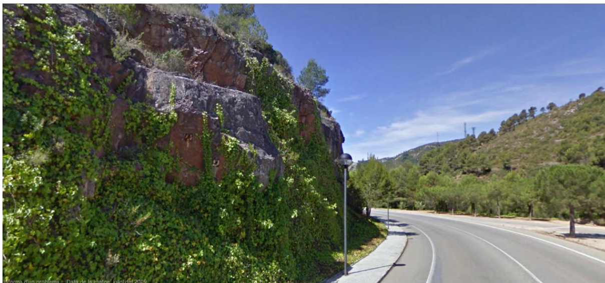
Imatge 2 talús a la carretera C-44 al seu pas per Vandellòs
